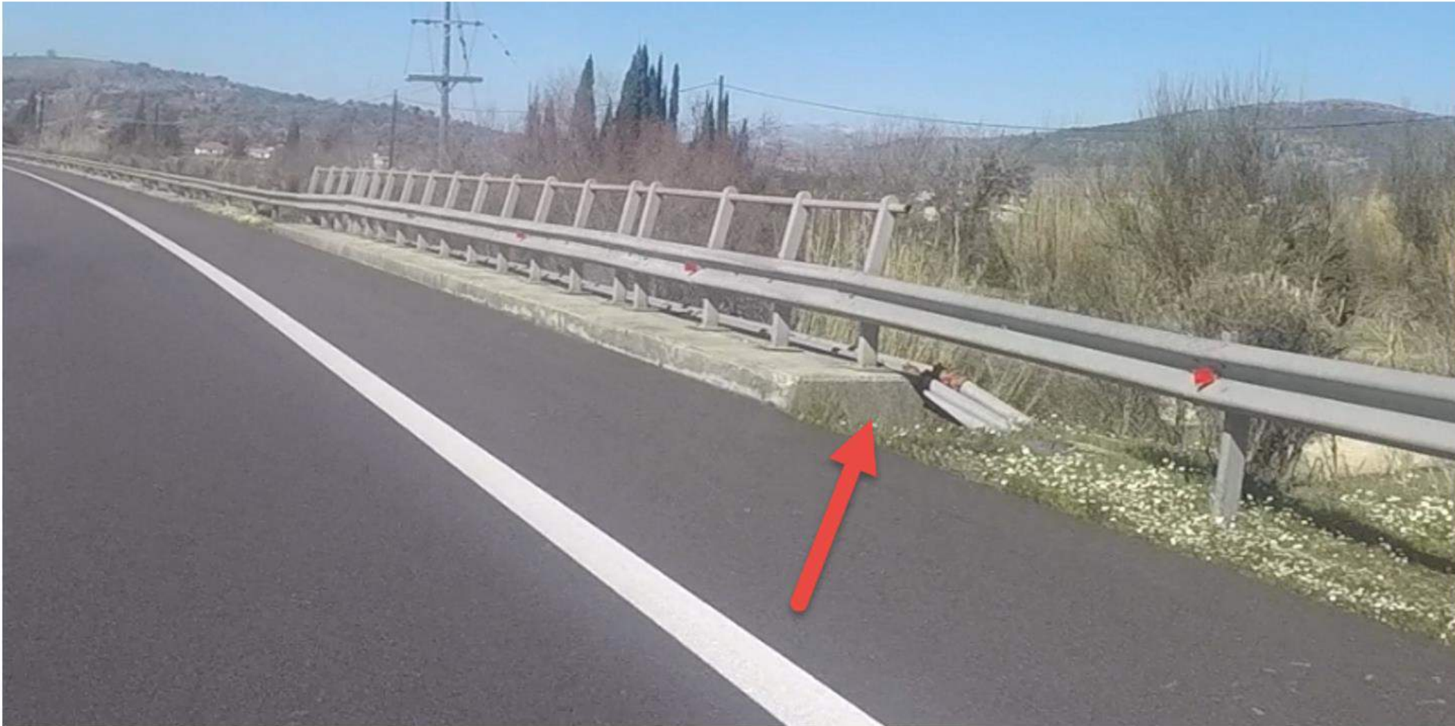
Κακή διαμόρφωση απόληξης πεζοδρομίου τεχνικού
