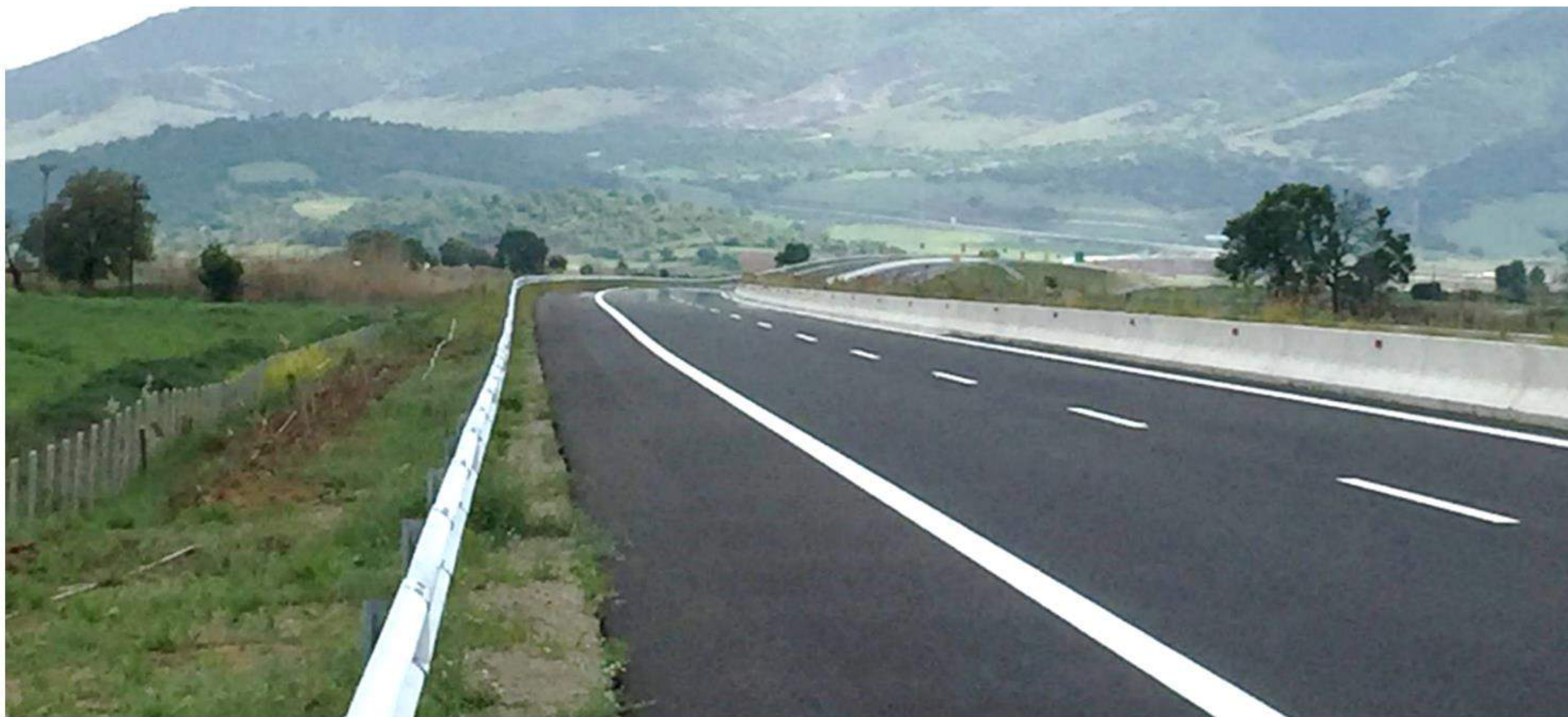
Περιοχή πιθανής εμφάνισης προβλημάτων υδρολίσθησης ΧΘ \approx 62+800
